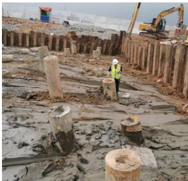
(a) 开挖后淤泥裸露
