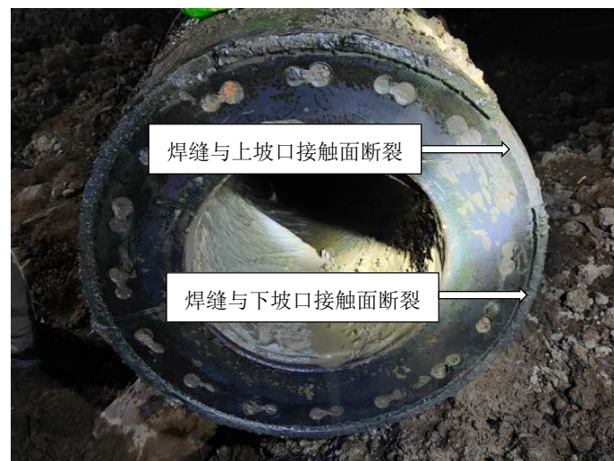
图 C.5.4-2 X-292#桩上节桩拔起后接头处的破坏形态
