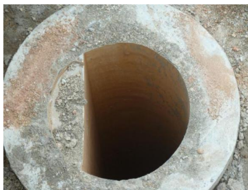
图 27 预应力混凝土管桩内腔沉浆矢高过大示例
