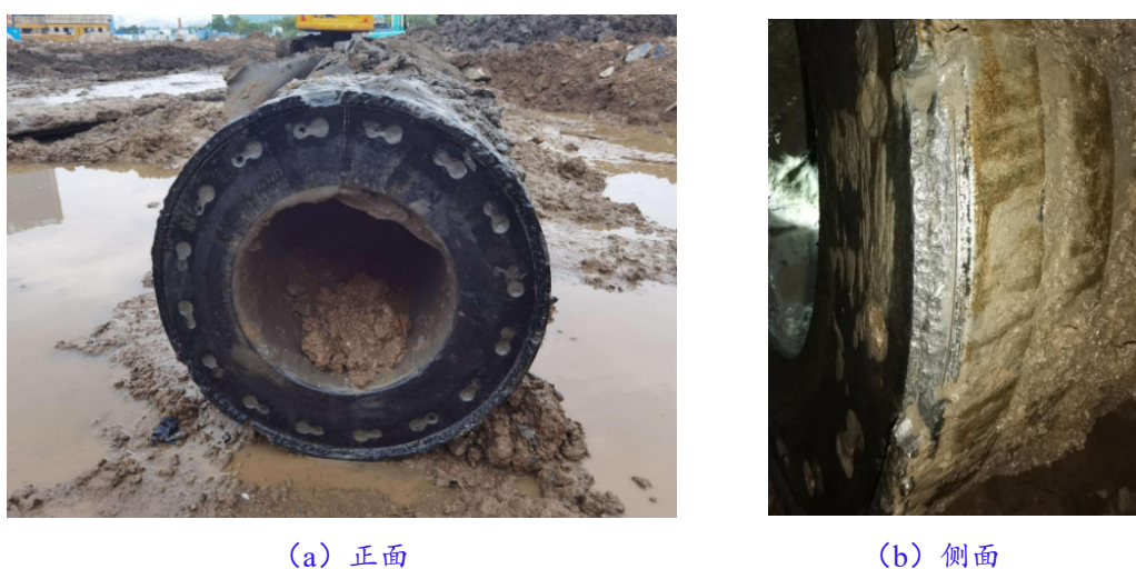
图 30 抗拔试验桩第一节桩拔出地面后断口处的状况
