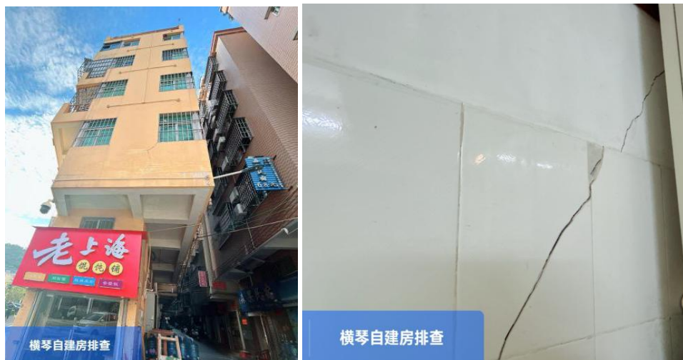
图 2 主体结构倾斜、沉降裂缝
