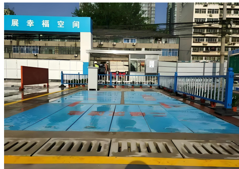
标准化三级沉淀池通过三级沉淀去除杂质， 处理施工污水
