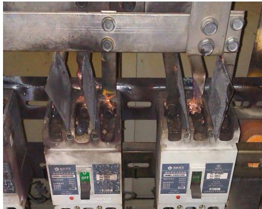
电气设备漏电与短路风险
