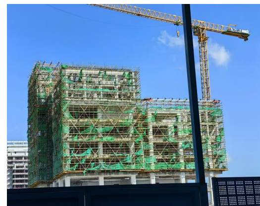
台风后脚手架安全网损坏
