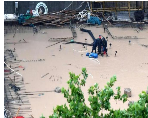
暴雨后施工现场被浸泡
